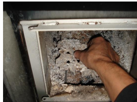
Arina nostetaan kiukaan sivuseinälle puhdistuksen ajaksi. Sitten kolataan pinnat tuhkasta puhtaaksi kohennusraudalla.
